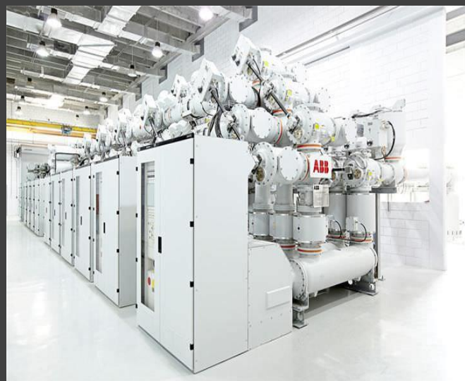
Ilustración 3. Interruptor de alto voltaje ELS-14 con aislamiento de gas.
